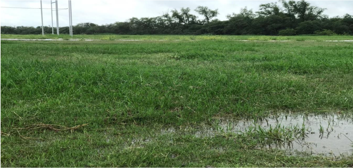
Agua estancada y falta de drenaje
