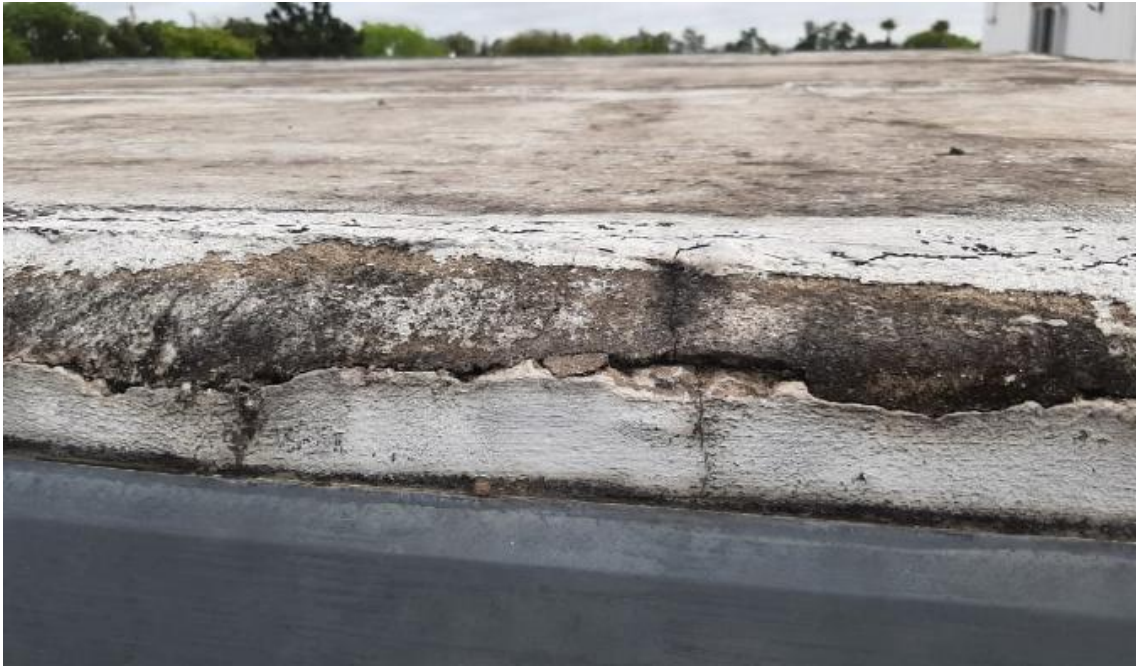
Imagen 3 – Pequeños agrietamientos en loza
