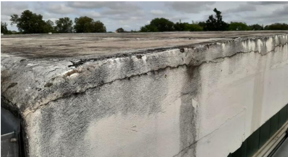
Imagen 2 – Rajaduras longitudinales en loza superior
