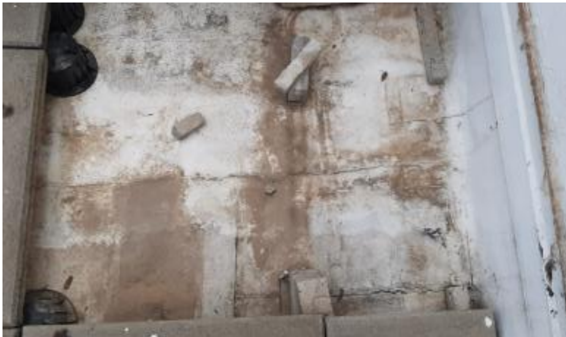
Imagen 4 – Agrietamientos transversales en cauces pluviales (debajo de las losetas)
