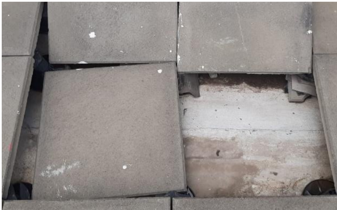
Imagen 5 – Agrietamientos longitudinales en cauces pluviales. Soportes de losetas dañados.
